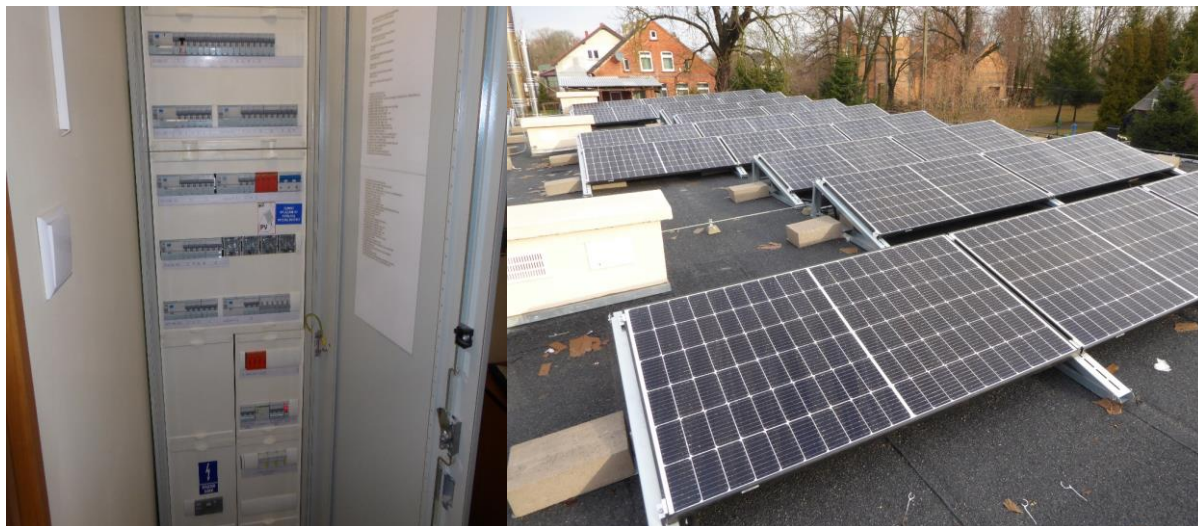
Instalacja fotowoltaiczna – przedszkole w Grabiku
